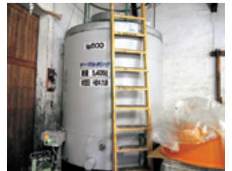
サーマルタンク
