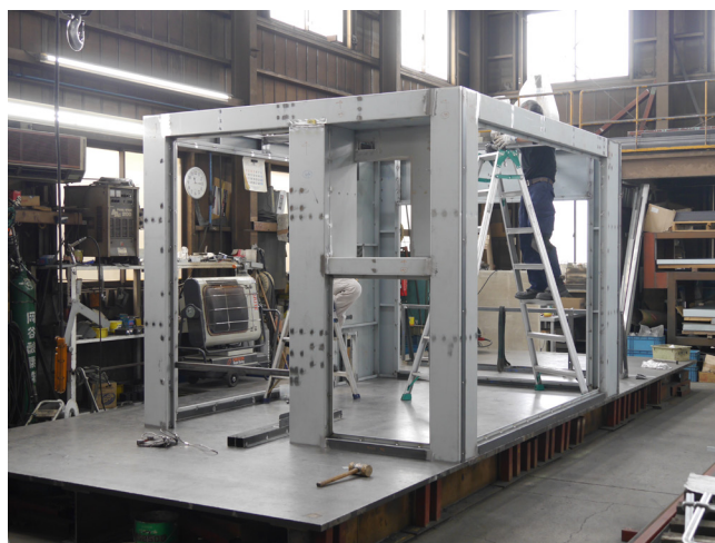
防音ボックスのフレーム
