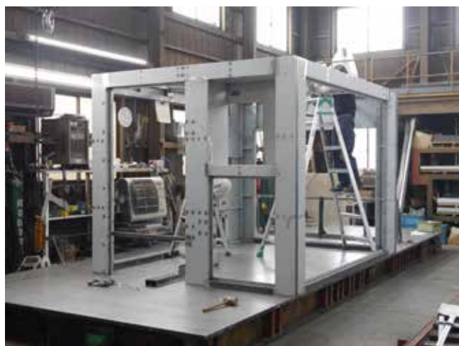
防音ボックスのフレーム
