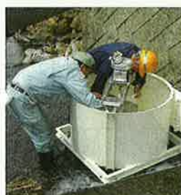
小水力発電装置
