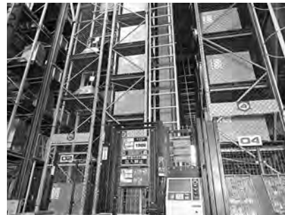
松本物流センターの自動倉庫（リニューアル済み）
