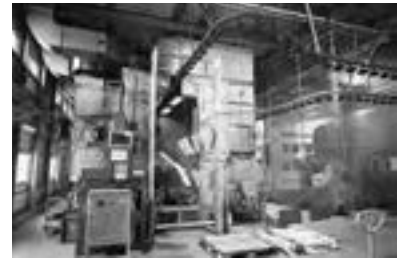
自動塗装ラインと付属する遠心式スラッジ除去装置
