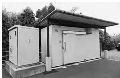
店舗敷地内に設置したプレハブ冷凍庫
