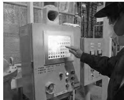
高機能タッチパネルモニターにより集中管理・制御
