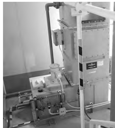
スクラバー装置（排気洗浄装置）
