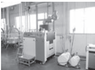
高圧処理装置
