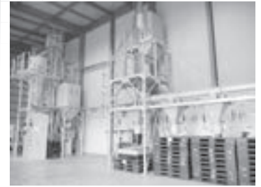
自家精米設備
