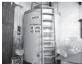
サーマルタンク
